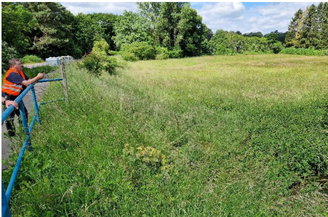
Zugewachsener Bachdurchlass in der Jägersburger Straße
