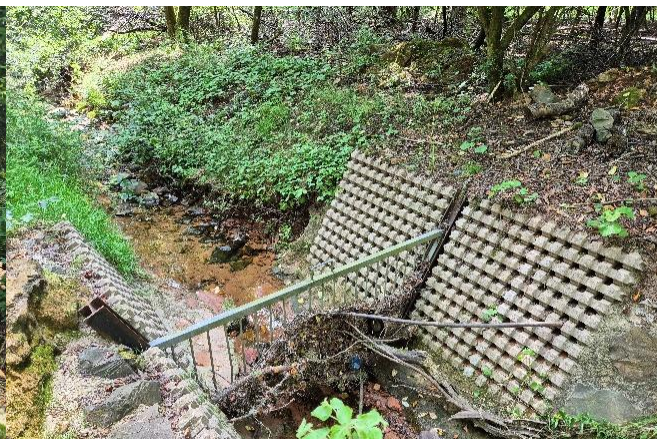
Treibgutfang im Gewässer entlang des Fußweges
