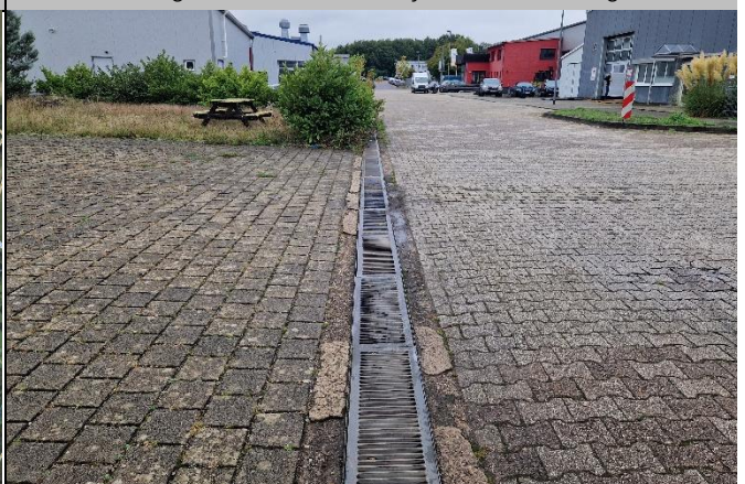
Entwässerungsrinnen an den Straßen im Gewerbegebiet
