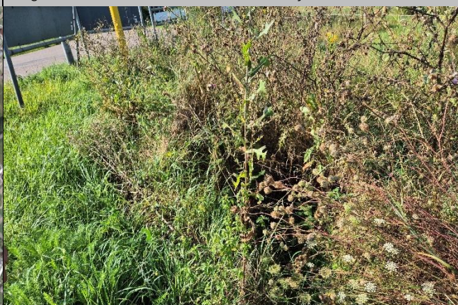
Zugewachsener Einlassbereich am Straßendurchlass
