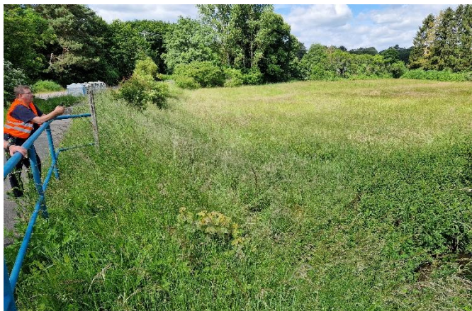
Zugewachsener Bachdurchlass in der Jägersburger Straße
