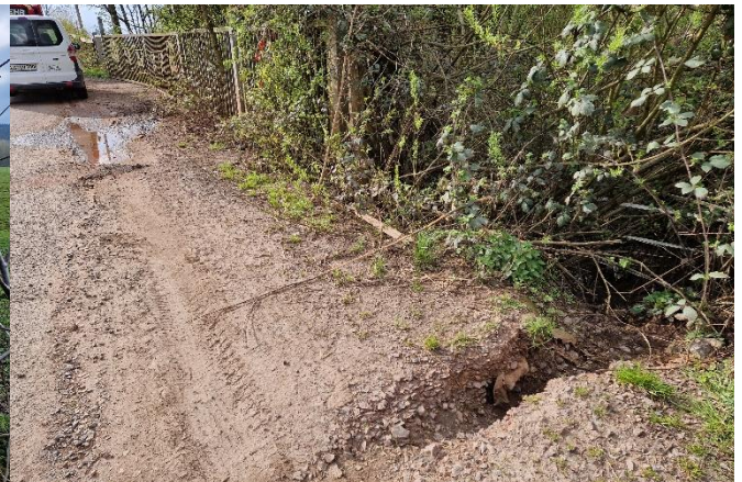
Ausspülungen am Auslassbereich des Durchlasses
