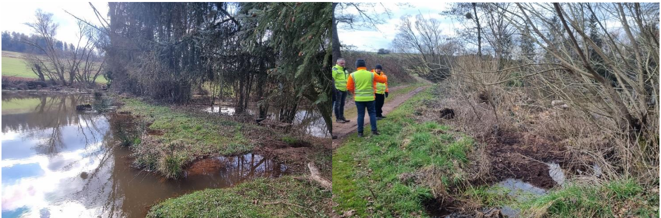
Überspülter Damm an einer privaten Weiheranlage | Zugesetzter Nebenschluss des Herrnbaches am Weiher
