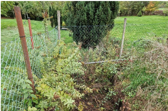
Defizite am Bach oberhalb der Verrohrung
