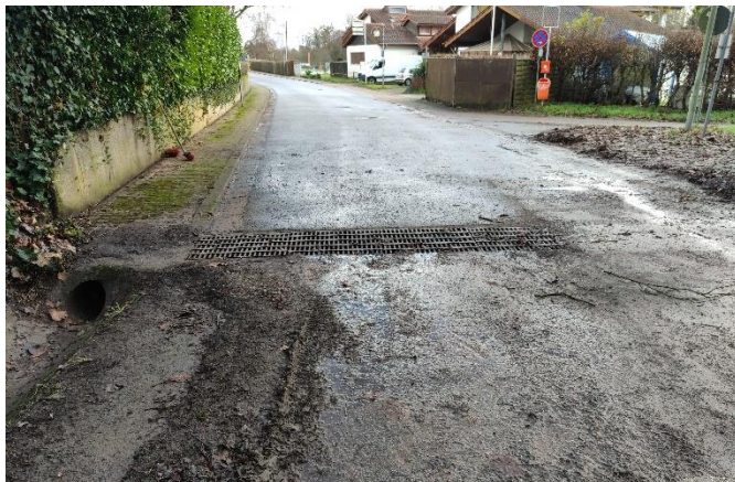
Rohreinlass und Rinne im Übergang zum Wirtschaftsweg
