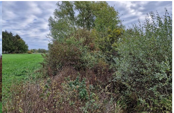
Zugewachsener Durchlass im Weg
