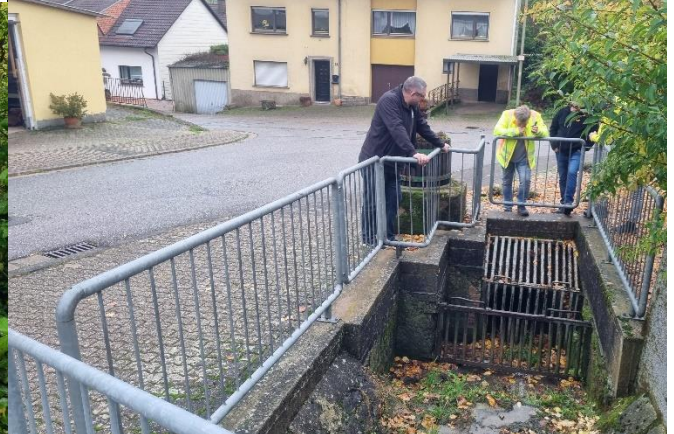
Einlassbauwerk an der Straße „Am Hohberg“
