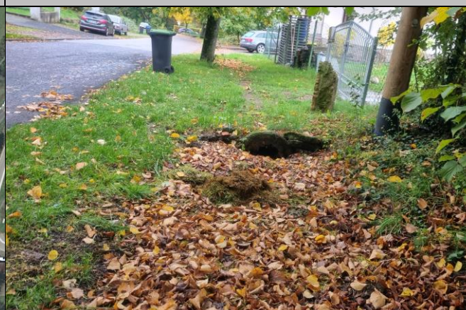
Zugesetzte Straßenentwässerungseinrichtungen d. Ihner Str.
