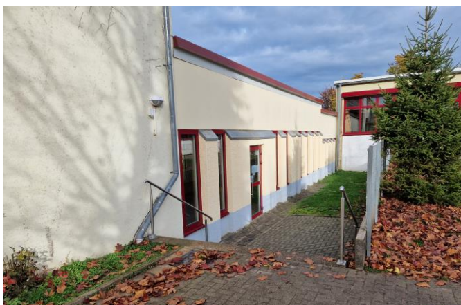
Tieferliegender, gefährdeter Bereich am Schulgebäude
