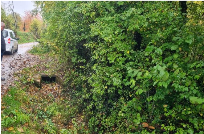
Wegeentwässerung oberhalb/ Zuleitung zur Gräth
