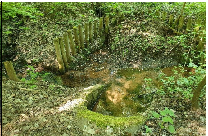
Treibgutrückhalt vor dem Durchlass in der Straße
