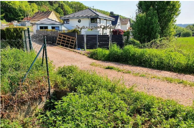
Bachdurchlass im Weg
