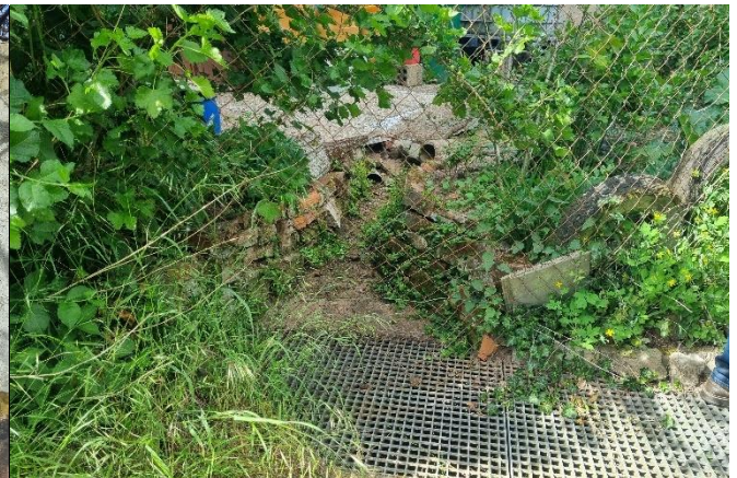
Einlassbauwerk der Außengebietsentwässerung
