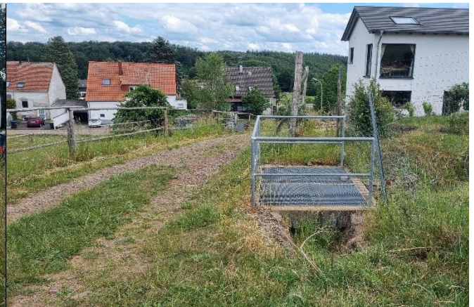
Einlassbauwerk oberhalb d. Bebauung d. Mitlosheimer Str.
