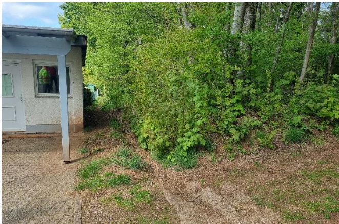
Entwässerungsrinne und Einlass (Im Eichenwäldchen 19)
