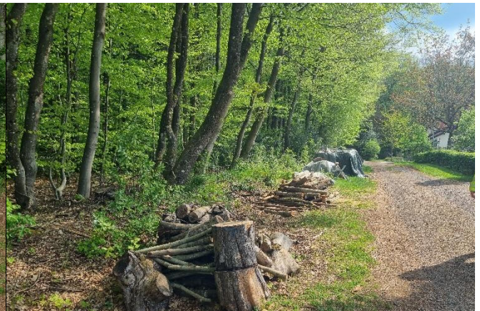
Nicht mehr funktionsfähige Rinne aufgrund v. Lagerungen
