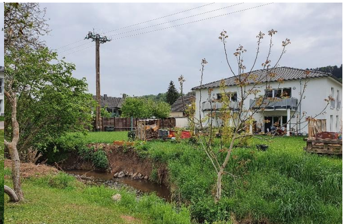
Böschungserosion am Bachlauf oberseitig der Brücke
